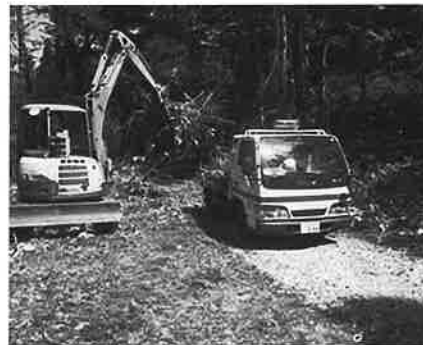
「R48しあわせ街道学びの森」 (有)双伸工業による現地整備
