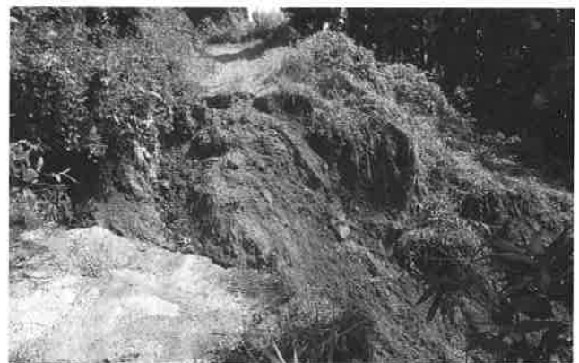
大蔵村 熊高桜峠線 復旧延長 L=26m 路体流出
