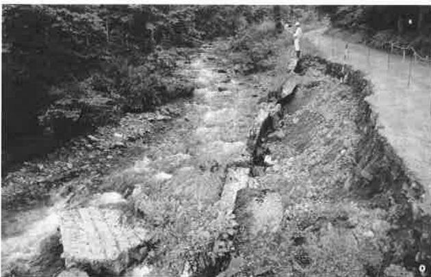
飯豊町 東沢線 復旧延長 L=24m 路肩欠壊
