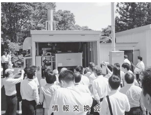
チップボイラー(200kw)
